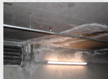
Oberseitig fehlende Abdichtung, feuchtigkeits- und tausalzführende Risse in der Decke
