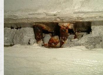
Korrosionsspuren unter einer Brüstung, im Zuge der Inspektion erkannt
