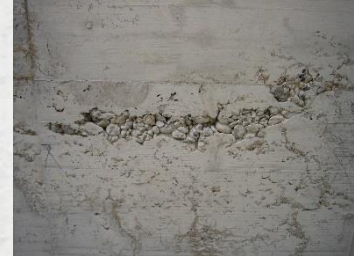
Kiesnest im Wandbereich, festgestellt nach dem Entfernen der Schalung im Zuge der Bauqua
