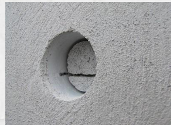
Untersuchung von Putzrissen an einer Fassade
