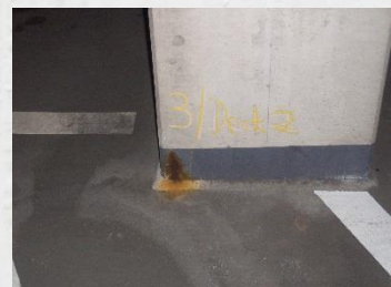
Korrosionsspuren im Fußbereich einer Stütze im Parkhaus
