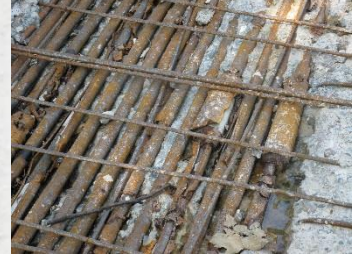
Korrodierte Bewehrung einer Fußgängerbrücke aus Spannbeton
