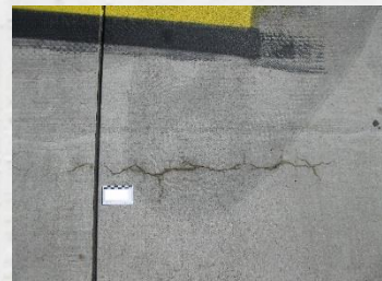
Rissbildungen im Vorfeldbereich oberhalb der Dübel (AKR)
