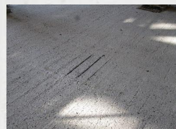
Bodenfläche mit freiliegender Bewehrung, Dauerhaftigkeit und Anforderungen Brandschutz nicht gewährleistet
