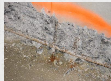
Wandfuß im Neubau, nicht ausreichende Betondeckung, bereits sichtbare Korrosionsspuren, bei Bauqua festgestellt
