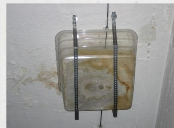
„Hausmeisterlösung“ zur Verhinderung des Durchtropfens von Wasser in einer ungewarteten Tiefgarage
