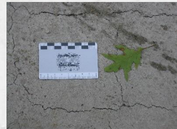
Rissbildungen auf Deckenoberseite, zu geringe Betondeckung, verminderte Dauerhaftigkeit
